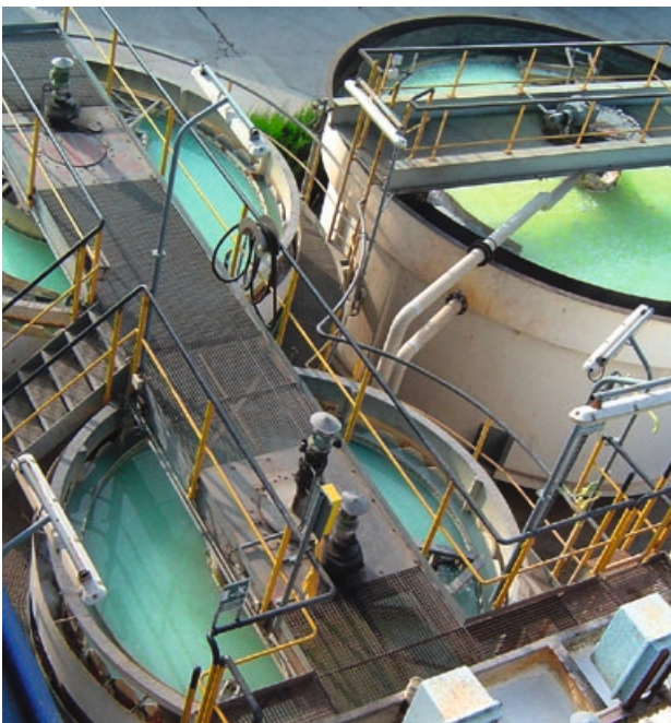
Planta de tratamiento físico-químico de aguas del centro de BASF en La Canonja (Tarragona).
